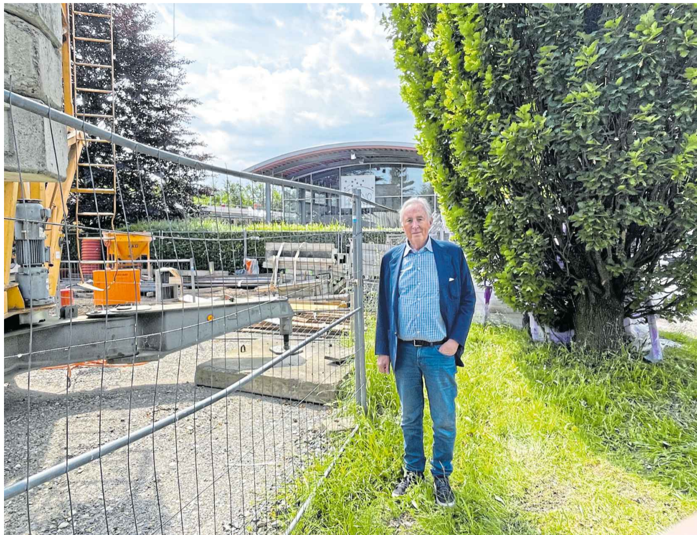
Heiner Wemhöner steht vor der Baustelle an der Lockhauser Straße, aus der bald das neue Kunst-Depot werden soll. Im Frühjahr 2025 soll hier Eröffnung gefeiert werden – für einen öffentlich zugänglichen Schau-Bereich und ein Lager für die umfangreiche Kunstsammlung Wemhöners.
